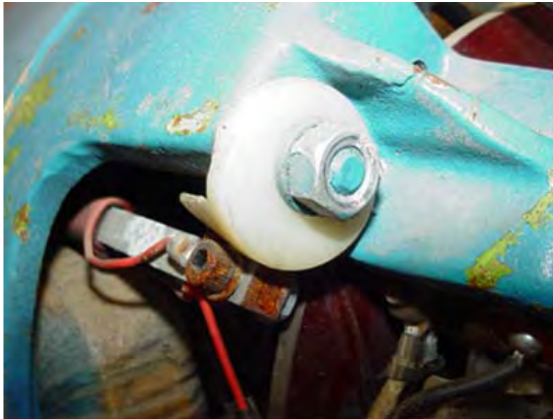
Sonde magnétique placé à côté de l'enroulement de Stator Vraisemblablement utilisé pour signaler la position angulaire
